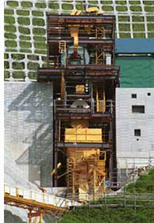
細骨材冷却設備 吉田ダム
